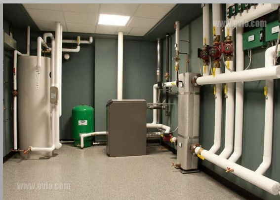
سیستم مرکزی (موتورخانه)
